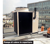
Pompa di calore in copertura.
